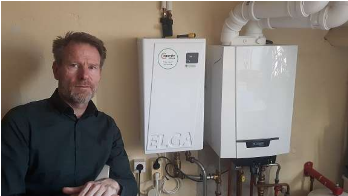
Inwoner Rob Kloppenburg. Links op de foto de binnen-unit van de warmtepomp. Rechts de HR-ketel.
